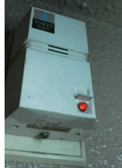
ガス漏れ警報器 玄関扉外壁
