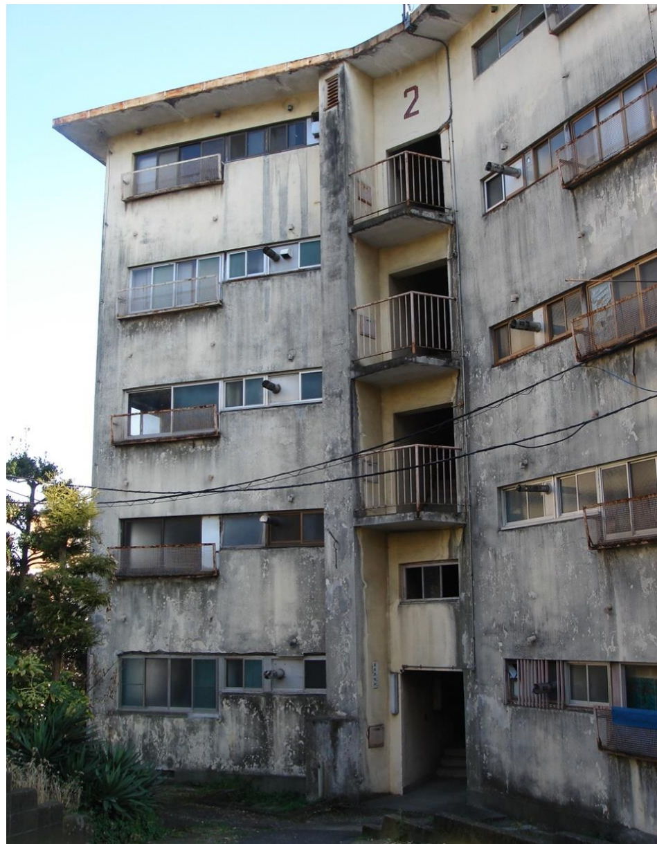
汚れ、ひびわれ、鉄筋露出が随所に見られる
