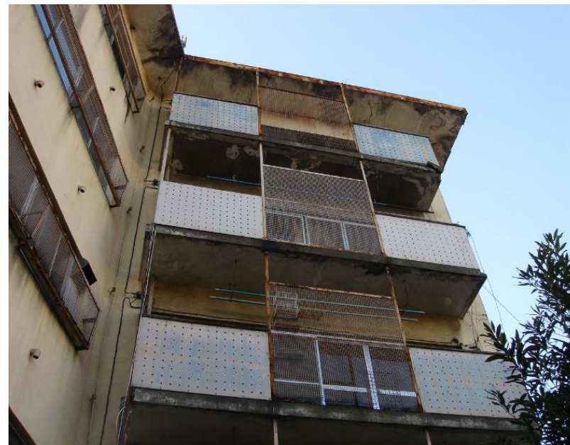
バルコニー天井・大庇の劣化が著しい
