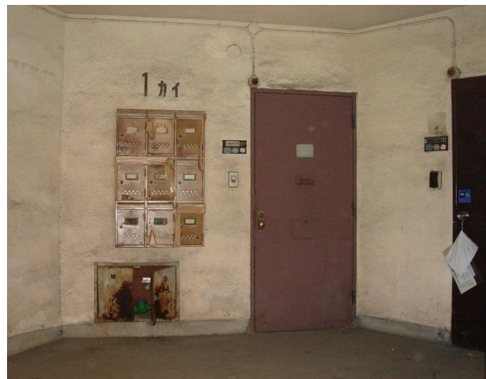
新築時のまま手入れがされていない玄関まわり
